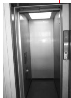
エレベーター
