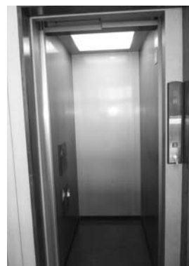
エレベーター
